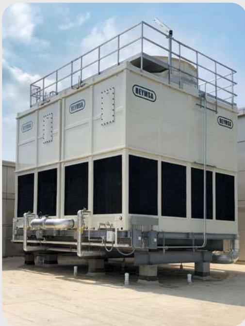
TORRES DE ENFRIAMIENTO
